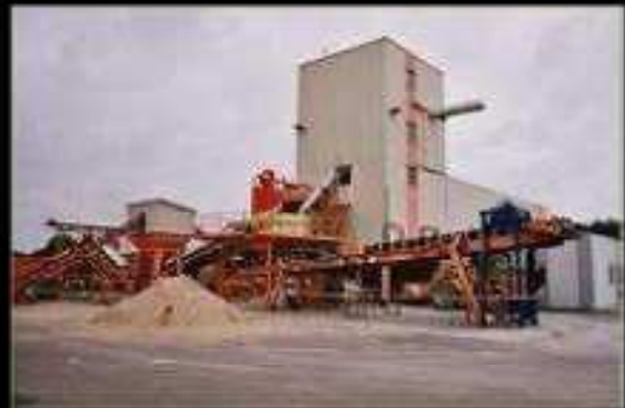
Rénovation du système de contrôle commande et de la supervision d'une station de malaxage à béton.
